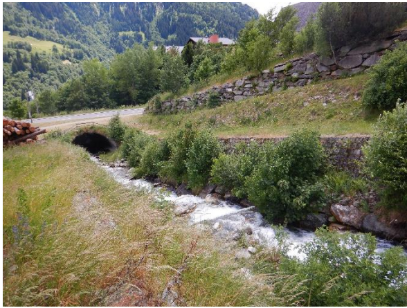
Kanal mit Sperrentreppe und im Hintergrund der rechte Lawinendamm, Blick in Fliessrichtung. DSCN5657.jpg
