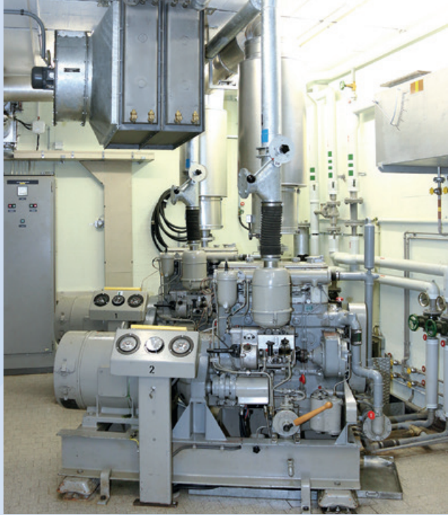
In agregat per la producziun d'energia electrica en cass da basegns.
